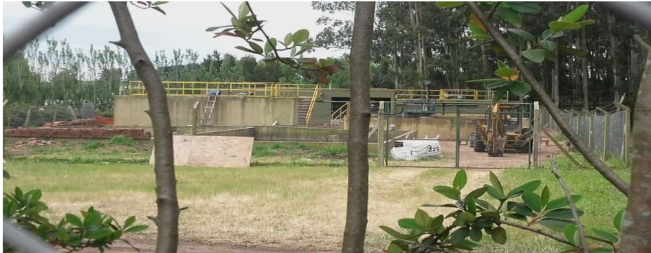
Figura 6: Planta de tratamiento de efluentes cloacales en Rumencó
