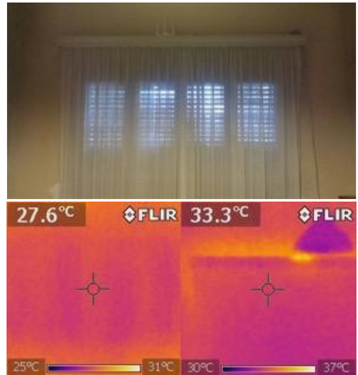
Figura 4. De izquierda a derecha: (a) Fotografía de la pared interior. (b) Imagen termográfica a las 7 am. (c) Imagen termográfica a las 8 pm. Fuente: Elaboración de la autora.
