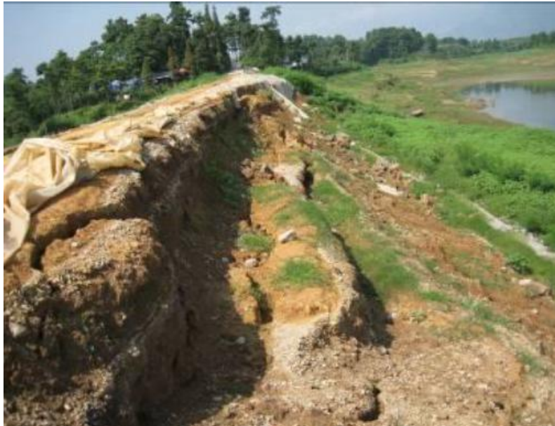
Fig. 3.2. Deslizamiento del talud aguas arriba de la presa de Feng-shou luego del sismo de Wenchuan, China, en el año 2008 (Obtenida de Chen et al., 2014).
