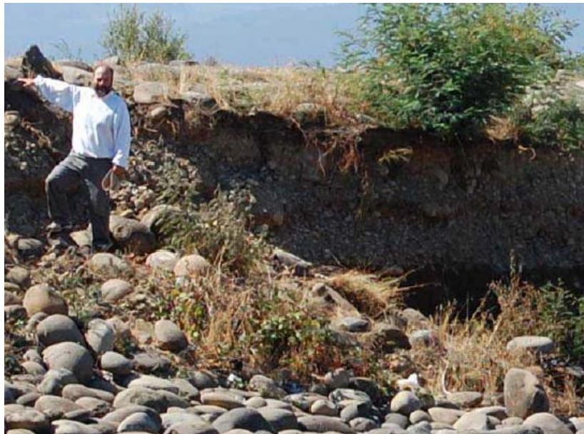
Fig. 3.3. Detalle del hundimiento (escarpa) en la zona del estribo de la presa de Coihueco, luego del sismo de Maule, Chile, en el 2010 (Obtenida de Bray et al., 2010)
