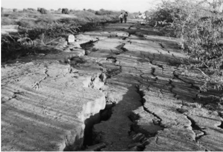
Fig. 3.1. Patrón de fisuración y movimientos diferenciales verticales en el coronamiento de la presa de Fategadth luego del sismo de Bhuj, India en el 2001 (Obtenida de Krinitzsky & Hynes, 2002).
