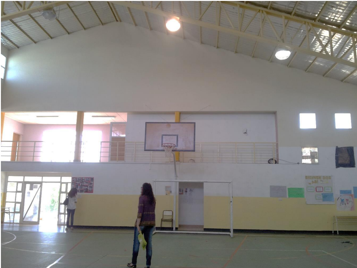
Foto N°4: a la izquierda puerta de ingreso a la escuela. En el centro, detrás del arco, el ingreso a la rectoría y la sala de profesores. En el centro superior un aula construida con material en seco. Se evidencian los huecos producidos por las pelotas de fútbol.
