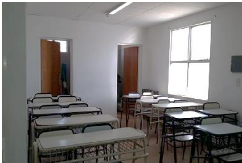
Foto N° 6: Aula en ex hall de entrada. Al fondo se observan dos baños fuera de servicio
