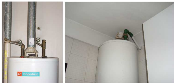
Fig. 4: Ubicación de hobos en el conducto de salida de los termotanques de las viviendas analizadas.
