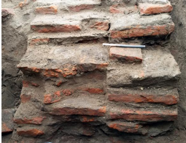
Detalle del aparejo del cimientto con la junta de tierra y cal pobre.
