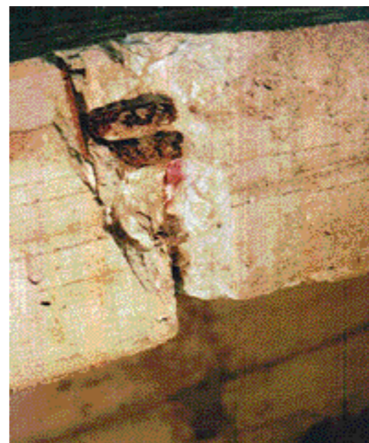
Figura 4. Deterioro de una estructura de hormigón armado por carbonatación. El \text{CO}_2 atmosférico reacciona químicamente con los productos de hidratación del cemento presentes en la solución alcalina de los poros del hormigón disminuyendo su alcalinidad y activando el proceso de corrosión de las armaduras.
