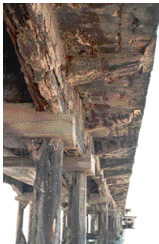
Figura 3. Estructura de hormigón armado expuesta al contacto con el agua salada.
