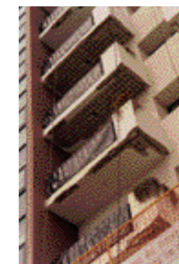
Figura 1. La corrosión que afecta la estructura metálica del hormigón armado provoca el deterioro de los balcones de este edificio.
