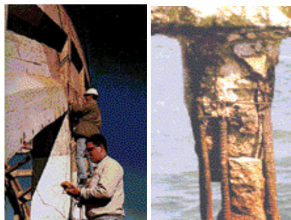
Extracción de información de estructura en un puente en la localidad de Cipoletti, provincia de Neuquén.
