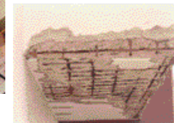
Figura 2. La loza comienza a deteriorarse como consecuencia del avance de la corrosión.
