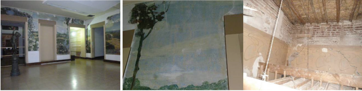
Figura 4: Vista del mural (izq.), fisuración del mural (centro) y fisuración por la parte posterior del mural (der.)
