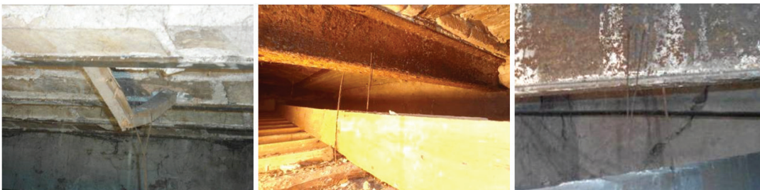
Figura 5: Soporte quebrado (izq.), viga y alambre de soporte cortado por corrosión (centro) y alambre de soporte de cielorraso cortado (der.)
