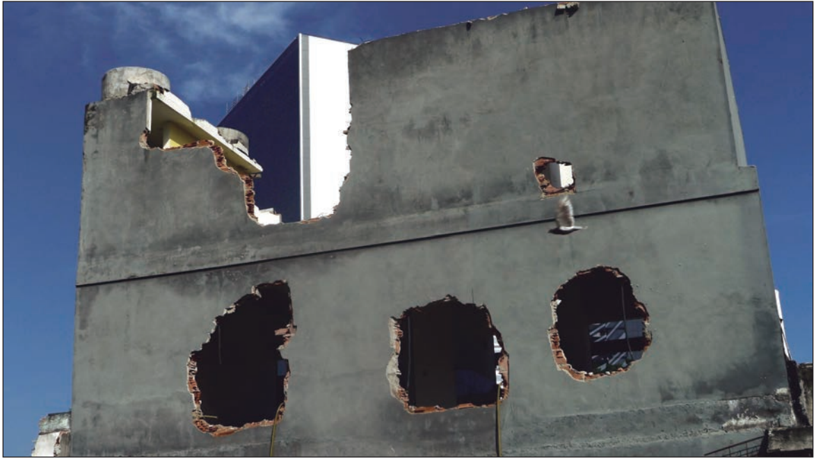
La ciudad revela el proceso. La construcción del Parque Olímpico se impone sobre Vila Autódromo, ese pequeño y viejo fragmento de ciudad que “limita e impide” su libre paso.
