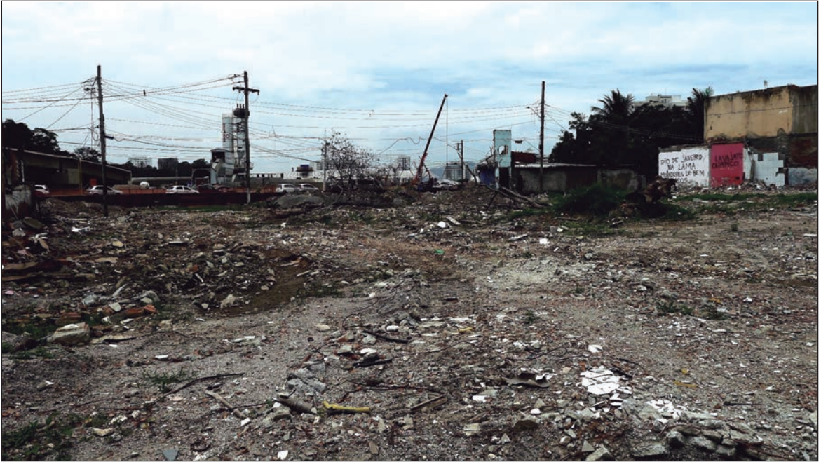
Vila Autódromo. En diciembre de 2015, pocas viviendas quedaban en pie de las más de 450 que había antes de que comenzara la construcción del Parque Olímpico en 2012.
