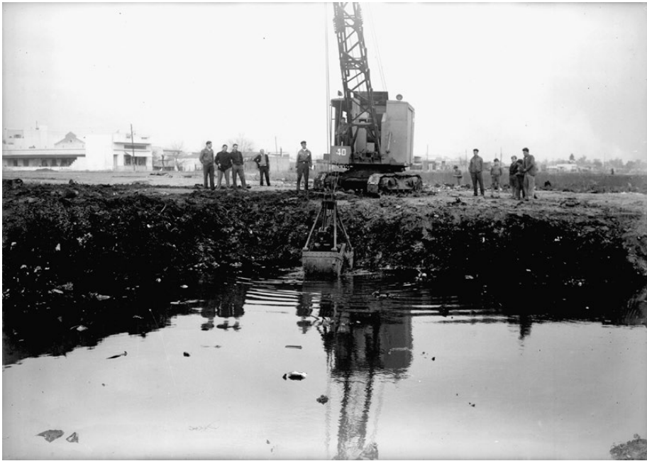
Fig 2. Soil removal as part of the Parque Almirante Brown programme. Source: Archivo Fotográfico de la Subsecretaría de Planeamiento “Alberto Aquilino López”, Gobierno de la Ciudad de Buenos Aires.
