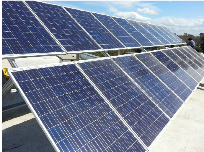
Figura 1: Sistemas FV de 4,8 \text{ kW}_p instalado en la terraza del edificio TANDAR (CAC).
