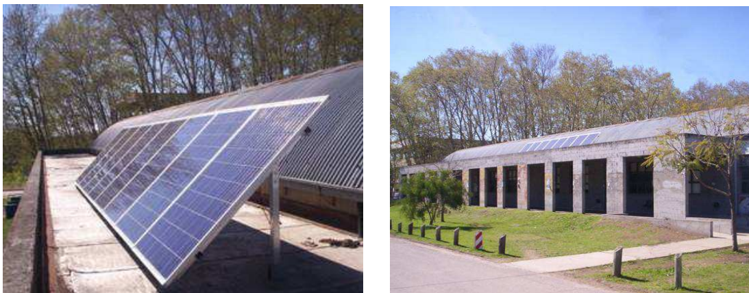
Figura 12: Sistema FV de 1,92 kW p instalado en la UNLu.
