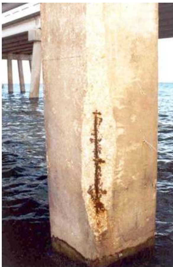
Fotografía 6. Pilote de un puente, con signos visibles de deterioro causados por la corrosión de las armaduras.
