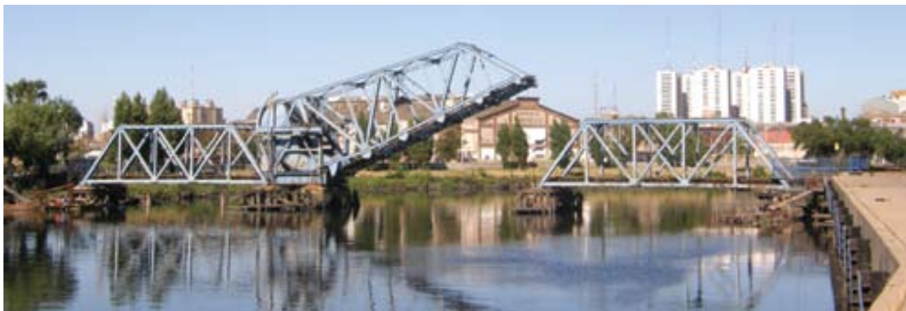
Antiguo puente ferroviario Barraca Peña, construido en 1913 por el entonces Ferrocarril Sud. Prácticamente en desuso.
