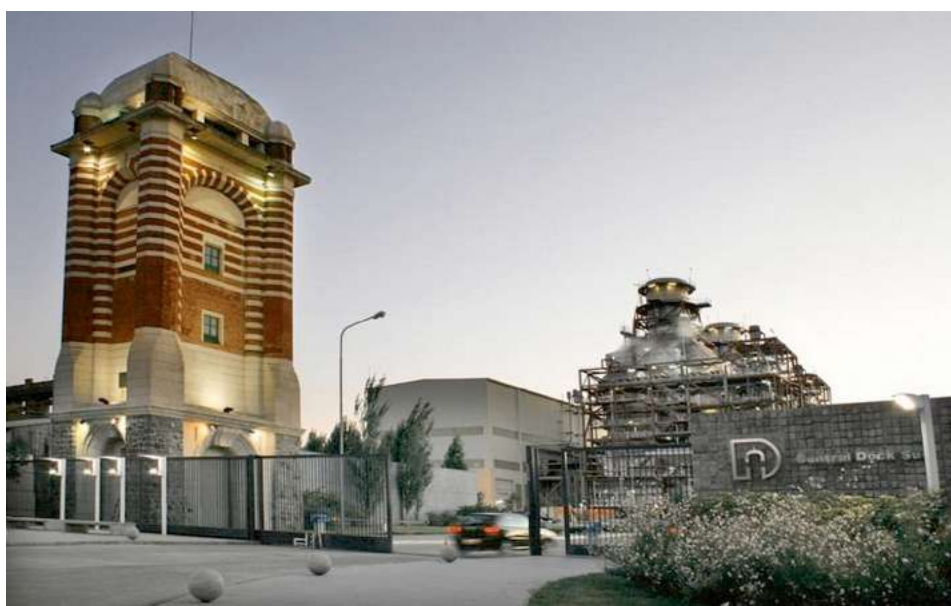
Figura nº 19. Central Térmica Dock Sud, Buenos Aires. Fuente: Ministerio de Economía de la Nación.
