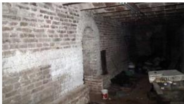
Arco de paso a las galerías de un pabellón con muestras de intervención reciente.
