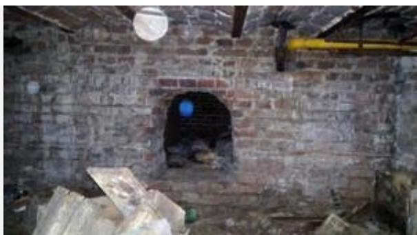
Apertura reciente de una de las paredes y cañerías de gas modernas.
