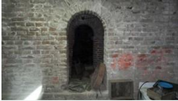
Arcos de paso entre un sector y otro, nótese que la altura va disminuyendo.
