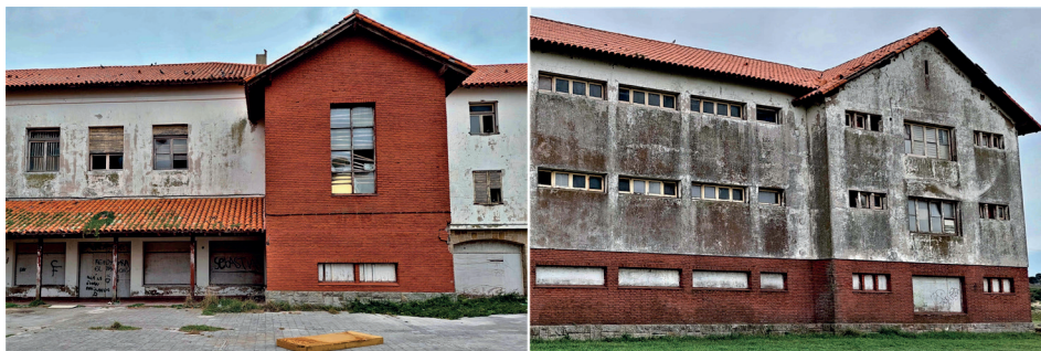
Imagen 1. Deterioro del Hotel 3 de la UT Chapadmalal al sur de la ciudad balnearia de Mar del Plata en junio de 2022
