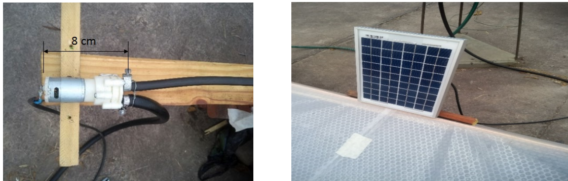
Figura 7: Fotos, de la bomba y del panel fotovoltaico (ambos de 5W).
