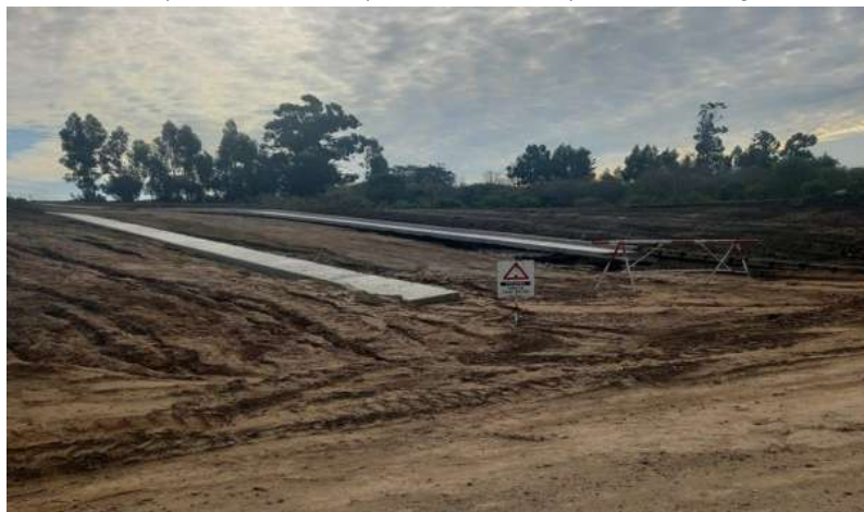
Figura 9. Obra vial que definió una pendiente más pronunciada y un nuevo cauce
