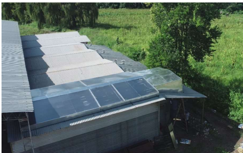
Figura 6: Fotografía aérea del sistema propuesto ya instalado en los techos de la estufa. Calentadores solares y envolvente a la unidad de calor.
