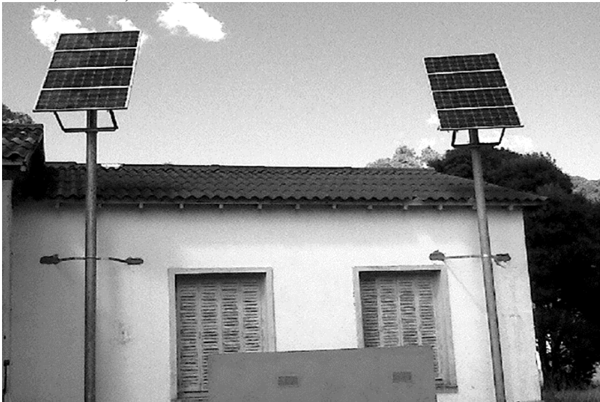
Figura n.º 4. Instalación fotovoltaica en la Escuela Primaria n.º 30 “Paraje San Cala” de Juan N. Fernández, Necochea, Buenos Aires
