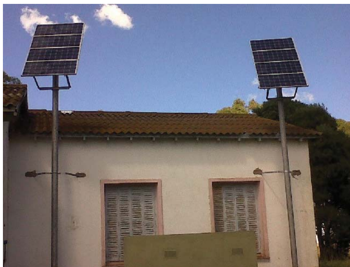
Foto N° 1. Instalación de energía eléctrica en la Escuela Primaria N°30 "Paraje San Cala" de Juan N. Fernández, Necochea, Buenos Aires.
