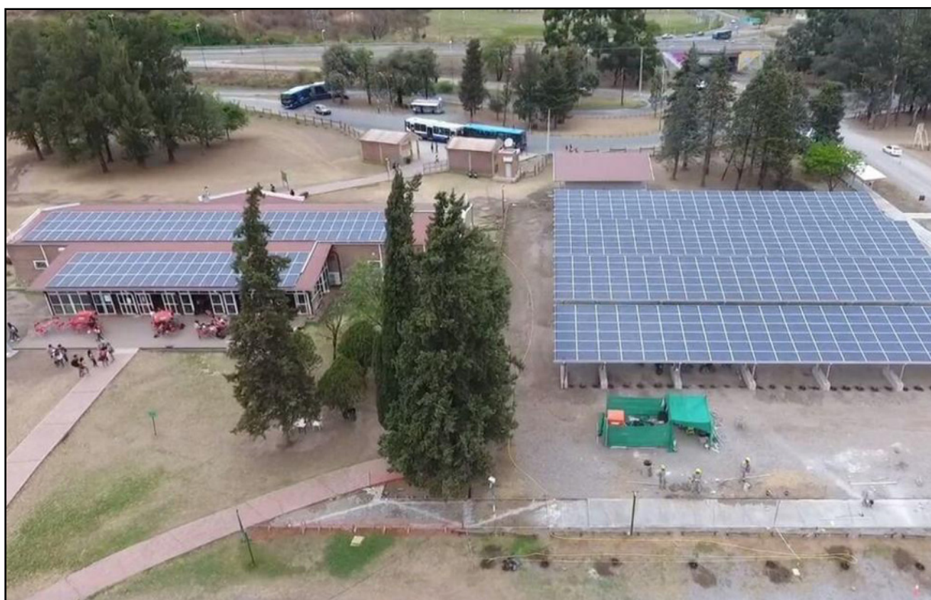
Figura 6: Instalaciones FV en el campus de la UCASAL - Salta. Se destacan sobre la derecha los refugios para estacionamiento con módulos fotovoltaicos integrados a la arquitectura (BIPV), en el cual se reemplazan las cubiertas metálicas habituales.
