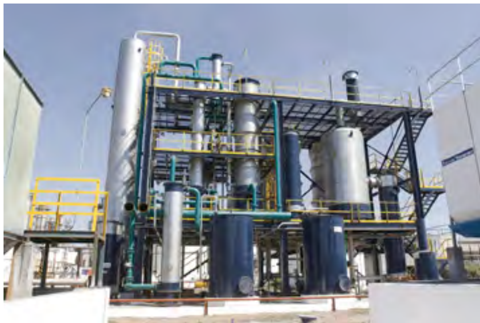
Figura n° 20. Planta deshidratadora de bioetanol en la provincia de Tucumán. Fuente: Ministerio de Desarrollo Productivo de la Provincia de Tucumán.
