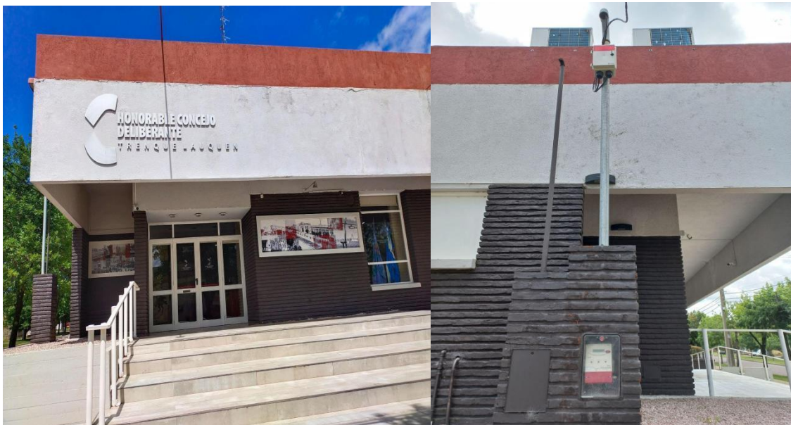
Fig. N°4: Instalación solar en el edificio del Concejo Deliberante de Trenque Lauquen
