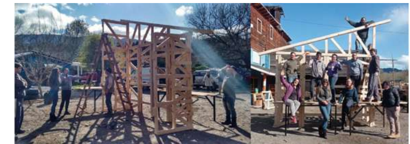
Fig. 5 y 6: Montaje inicial del módulo experimental producido de manera colectiva. Fuente: Archivo fotográfico del programa Co-construcción del Conocimiento.
