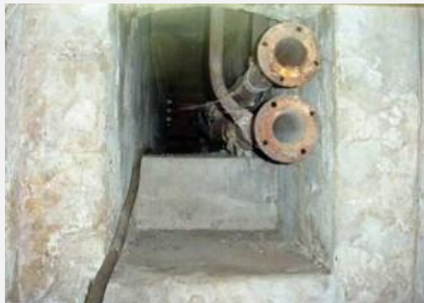
Paso de cañerías e instalaciones eléctricas por conductos de menor tamaño (foto archivo CAU).
