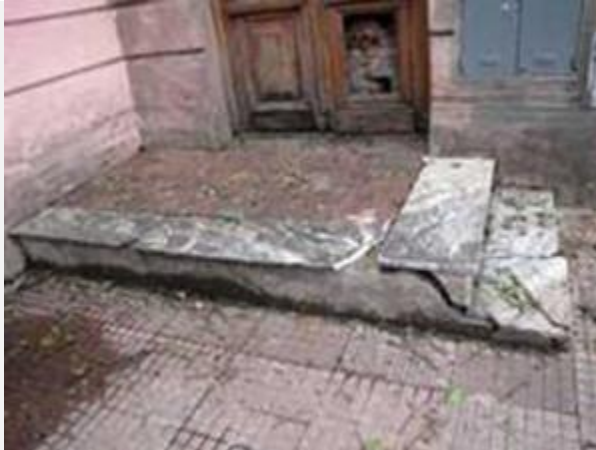
Una de las escaleras laterales del edificio que puede servir para tomar los mármoles y rehacerla con similares
