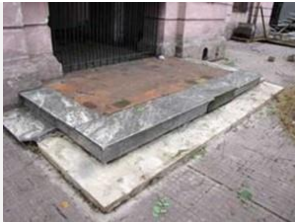
Escalera de acceso al edificio central con sus mármoles rotos.
