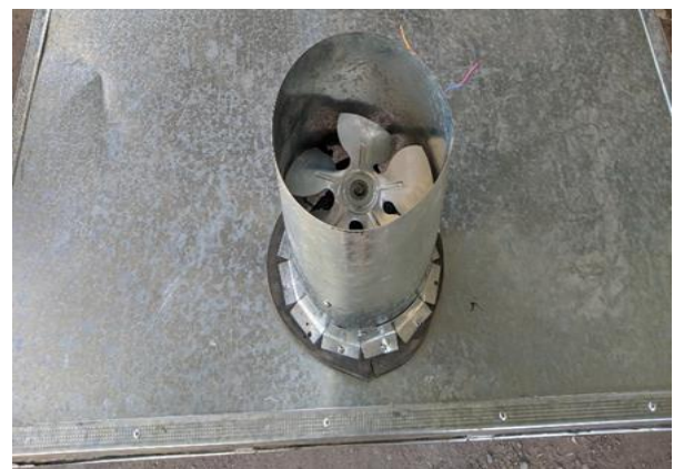
Fig. 6: Ventilador axial instalado en el ducto de salida.
