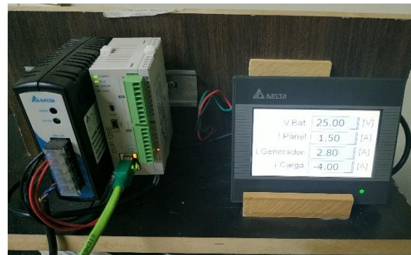
Fig. 4. PLC DELTA y HMI DELTA utilizados en la implementación.
