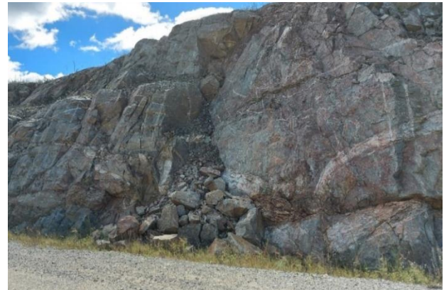
Fig. 20: Desprendimientos en el S1 del EG17.
