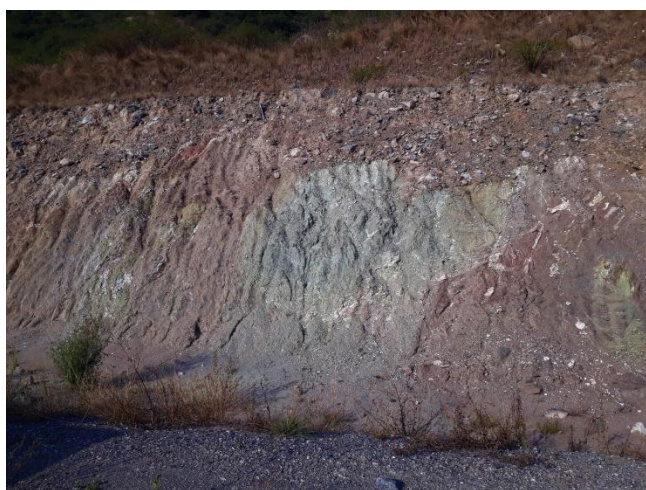
Fig. 5: Microbrecha de la falla de Sierra Chica, en proximidades del talud EG15 - RP34. Altura del talud 8,00 m.
