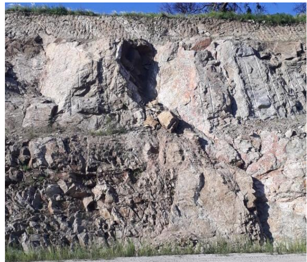
Fig. 21: Desprendimientos en el S2 del EG17.
