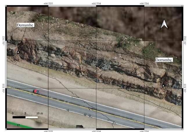
Fig. 15: Derrumbes en EG17. Sector S1 y S2.
