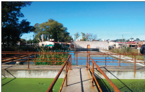
Figura 3. Piletas de la planta de tratamiento de efluentes cloacales. Autoría: Miembros del equipo del Vector Integración de Barrios Populares, Facultad de Ingeniería, UBA
