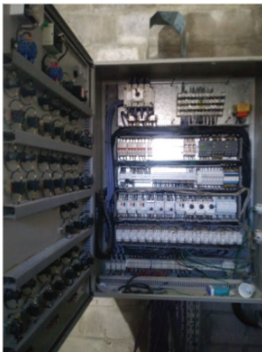
Figura 2. Tablero eléctrico perteneciente a la planta de tratamiento. Autoría: Miembros del equipo del Vector Integración de Barrios Populares, Facultad de Ingeniería, UBA
