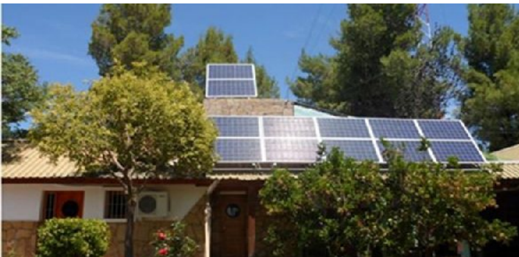
Figura 3b. Instalación domiciliar de 2,8 kW. El Chañar, Neuquén. Fuente: Departamento Energía Solar, Gerencia Investigación y Aplicaciones, CAC-CNEA.
