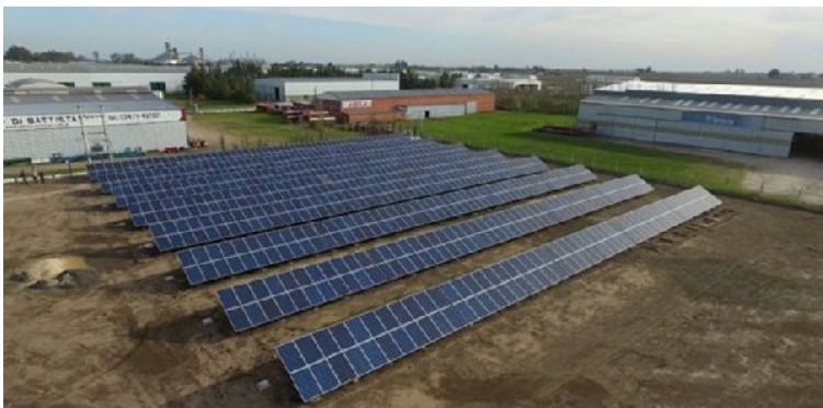
Figura 3a. Planta fotovoltaica de 200 kW. Armstrong, Santa Fe, Argentina. Fuente: Departamento Energía Solar, Gerencia Investigación y Aplicaciones, CAC-CNEA.
