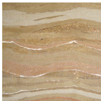
Foto de tapa: Muro de Tapial en la Casa Prior, Arq. Lucia Garzón Seccion 1, página 4.
