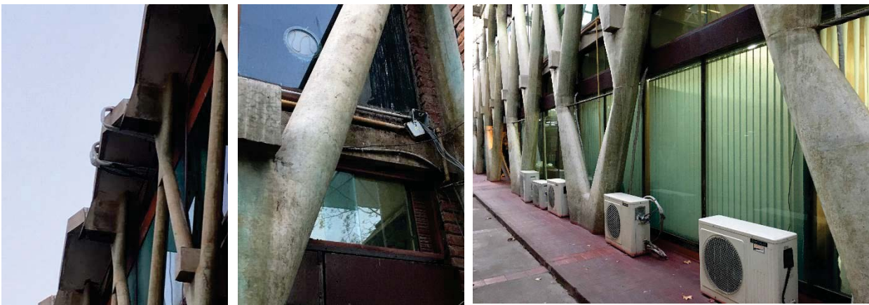
Fig. 14,15 Las imágenes ilustran las intervenciones de aparatos mecánicos de acondicionamiento.
