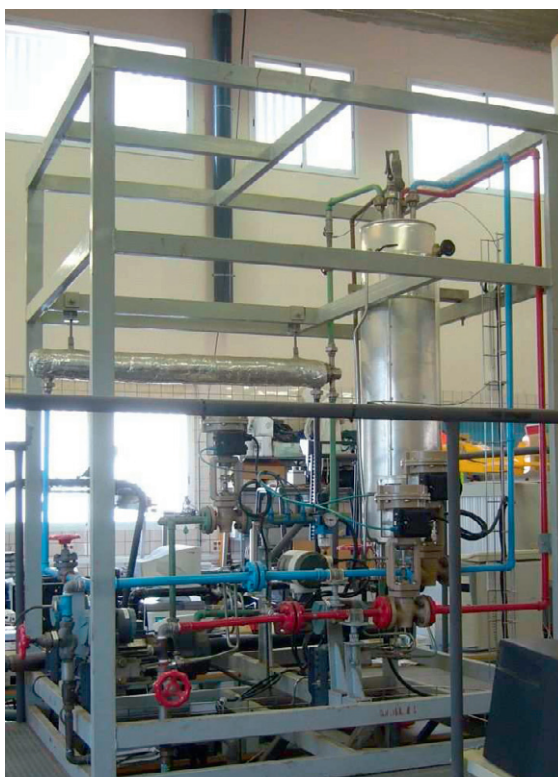
Figura 1: La planta piloto usada para la aplicación del MPC para seguimiento propuesto.
