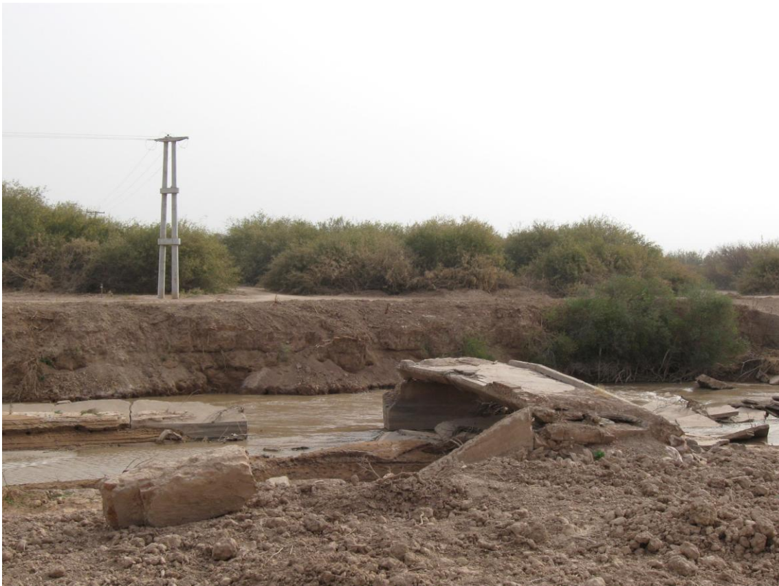
Figura 13. Restos del puente sobre el canal Gini a la altura del Km 14. Foto: Pablo Arístide, agosto de 2009.
