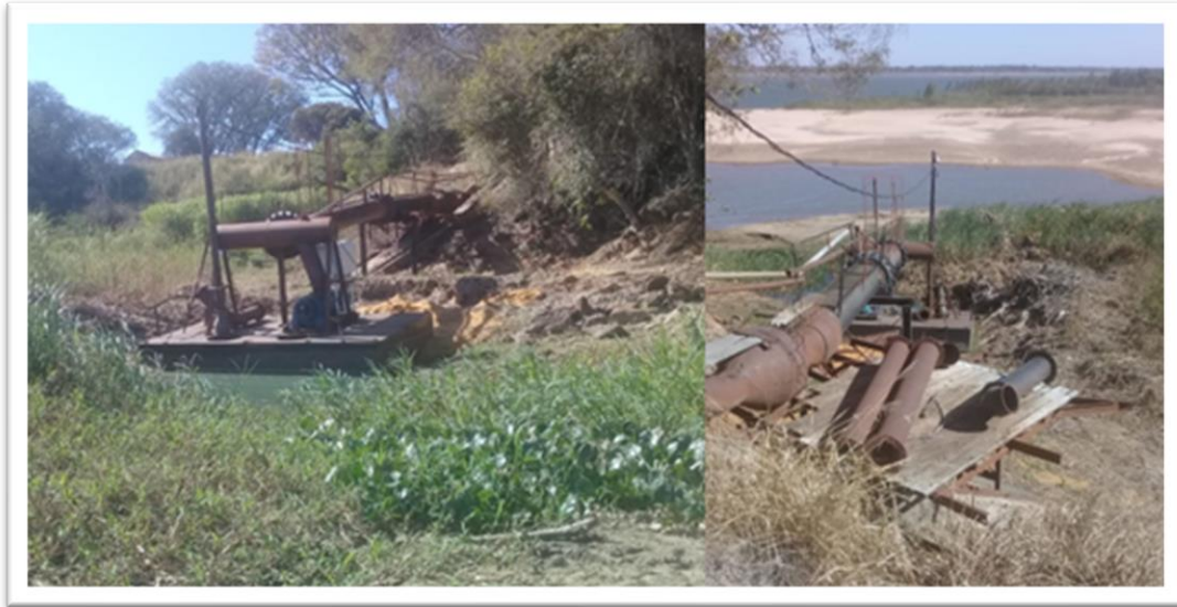
Figura 5. Toma de agua y bomba para riego de arroz sobre el río Paraná. En situación de bajante los productores muchas veces no podrán o será muy difícil adecuarse a la bajante (foto tomada el 28/07/2021 en Empedrado Corrientes).
