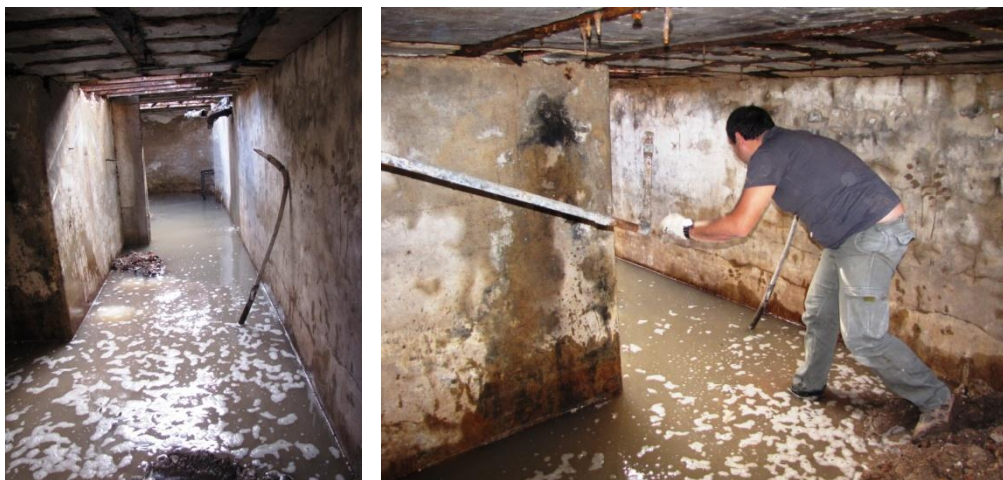
Galería rectangular ahora rellena con escombros y cubierta de agua.
