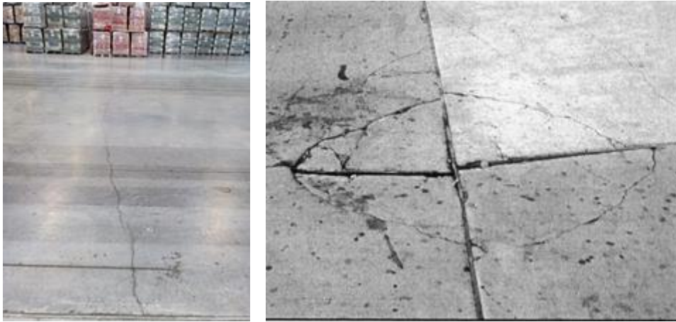
Figura 5. Fisuras de contracción por secado, promovidas por la restricción a la contracción que genera la fricción con el sustrato (izquierda) o por el alabeo de las losas (derecha [4]).
