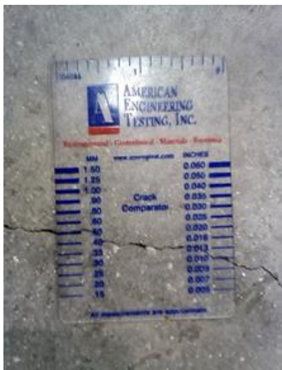
Figura 7. Evaluación del ancho de una fisura. La tarjeta con anchos graduados es la manera más usual de hacer la evaluación.
