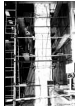
Figura 6. Detección de la RAS en las columnas interiores de un edificio en la ciudad de Buenos Aires.
