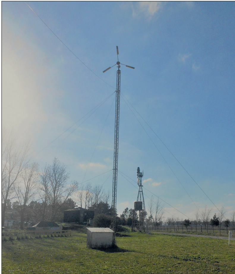
Foto 1. Aerogenerador en Escuela Agrotécnica Tres Arroyos (Buenos Aires)
