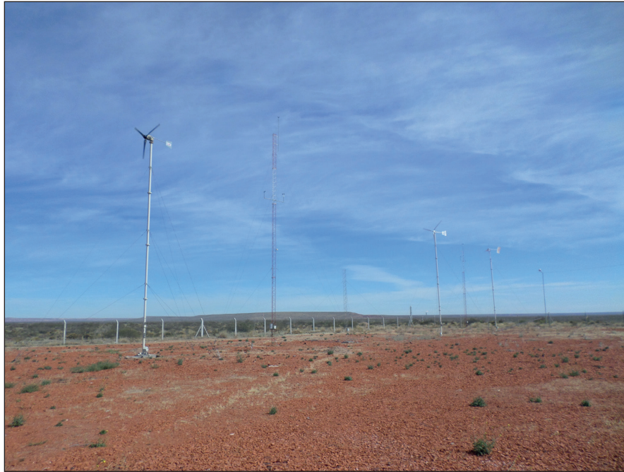
Foto 3. Plataforma eólica de ensayos de aerogeneradores de baja potencia del INTI
