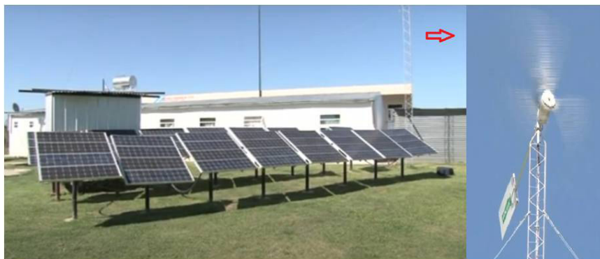
Figura 5. Instalación híbrida eólica-solar en Escuela N° 1312, Guaycurú
