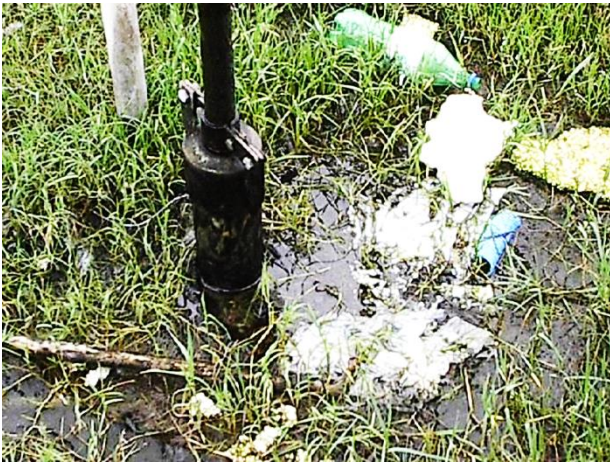
Foto 18: Mala construcción de una perforación con su boca en una depresión que puede favorecer el ingreso de contaminantes
