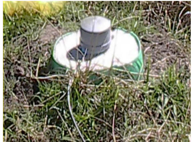
Foto 19: Construcción bien hecha con la boca del pozo elevada y protegida por un reborde de concreto.
