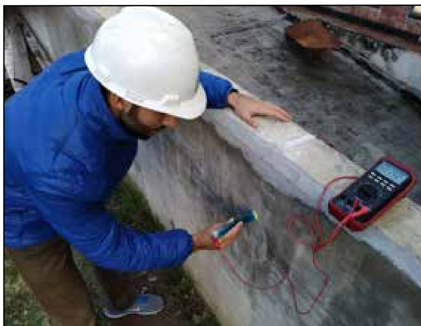
Figura 10. Medición del potencial de corrosión de las armaduras con un electrodo de referencia de cobre/sulfato de cobre saturado y un multímetro de alta impedancia.
