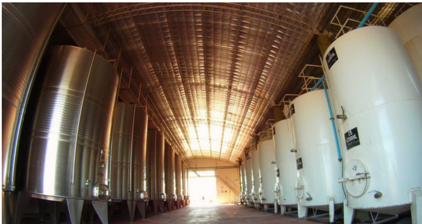
Figura 2. Interior de la bodega modelada y vista de la batería de tanques de acero inoxidable modelados para este trabajo (izq.) y de acero negro recubierto con epoxi (der.). Fuente: Empresa VC SA (2018).
