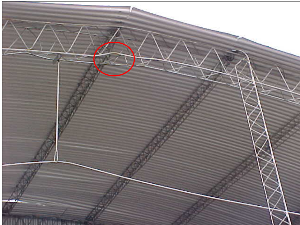
Figura 23: Falta de contraviento o contraviento inadecuado. Pandeo local del cordón comprimido del arco (SPRFV).
