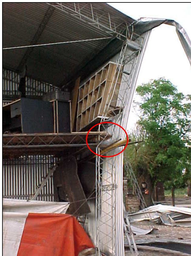
Figura 24: Pandeo localizado en columnas y arcos (SPRFV).
