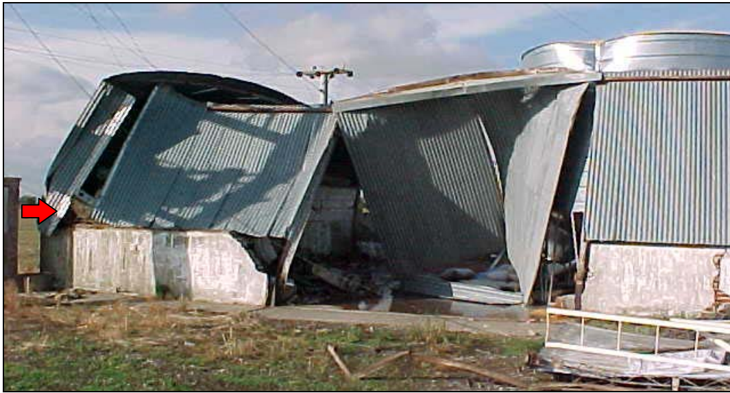
Figura 27: Falla de pórtico por esfuerzo horizontal en su plano. Falta de colaboración entre planos resistentes paralelos.
