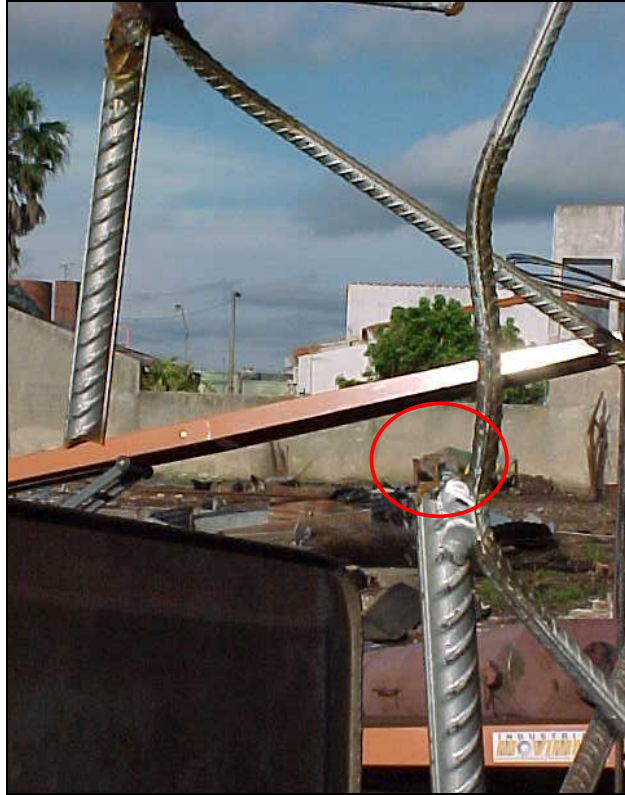
Figura 19: Falla en acero para hormigón armado soldado en columna de pórtico (SPRFV).
