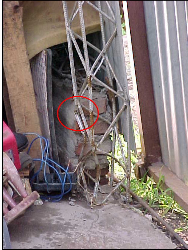
Figura 21: Falla en acero para hormigón armado soldado en columna de muro hastial (SPRFV).
