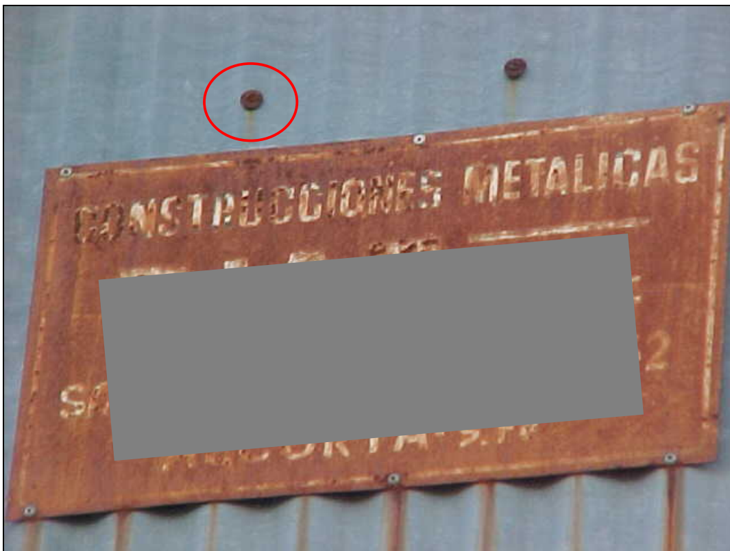
Figura 10: Fijación inadecuada de chapas (falta de arandelas)
