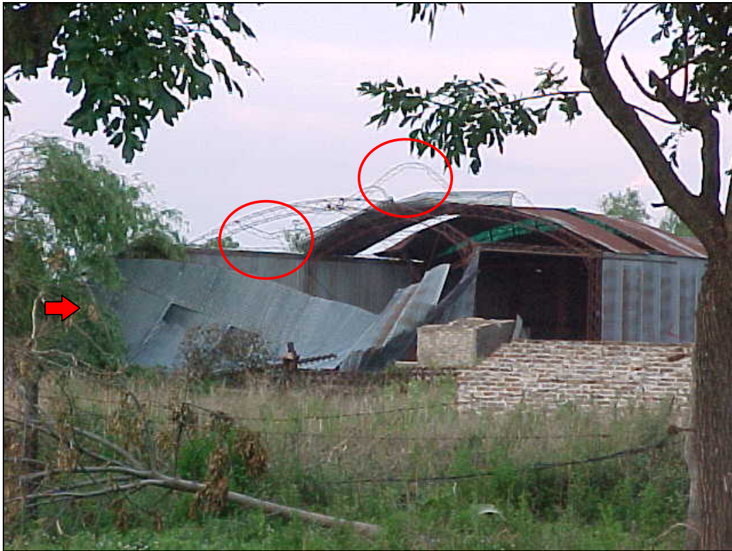
Figura 13: Pandeo general de las correas por empuje en el muro hastial a barlovento (SPRFV).
