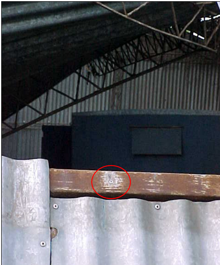
Figura 26: Detalle de Figura 25. Arrancamiento de chapas con fijaciones inadecuadas (remaches de aluminio tipo POP).
