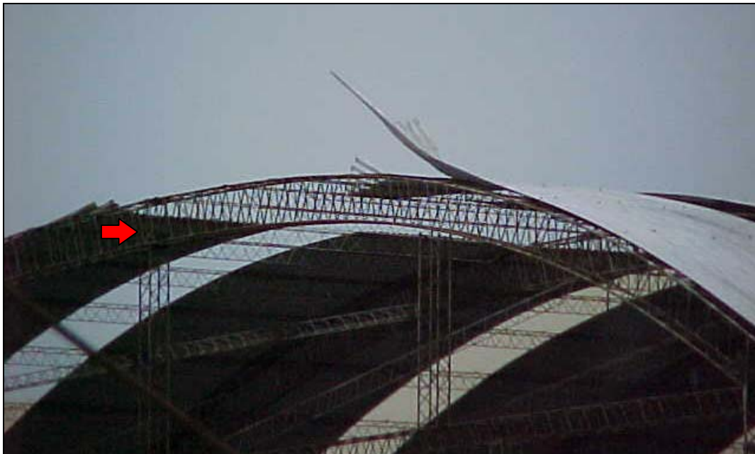
Figura 8: Arrancamiento de chapas (componentes y revestimientos, C&R), dirección del viento: desde la izquierda
