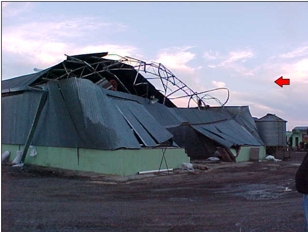
Figura 14: Pandeo general de las correas por empuje en el muro hastial a barlovento.
