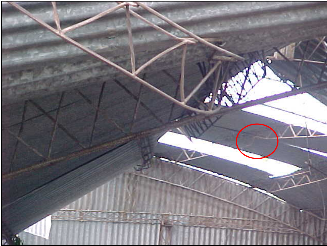
Figura 15: Pandeo de cordón comprimido en correa con sección "T" (C&R).
