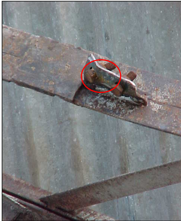
Figura 22: Falta de arandelas en uniones abulonadas.
