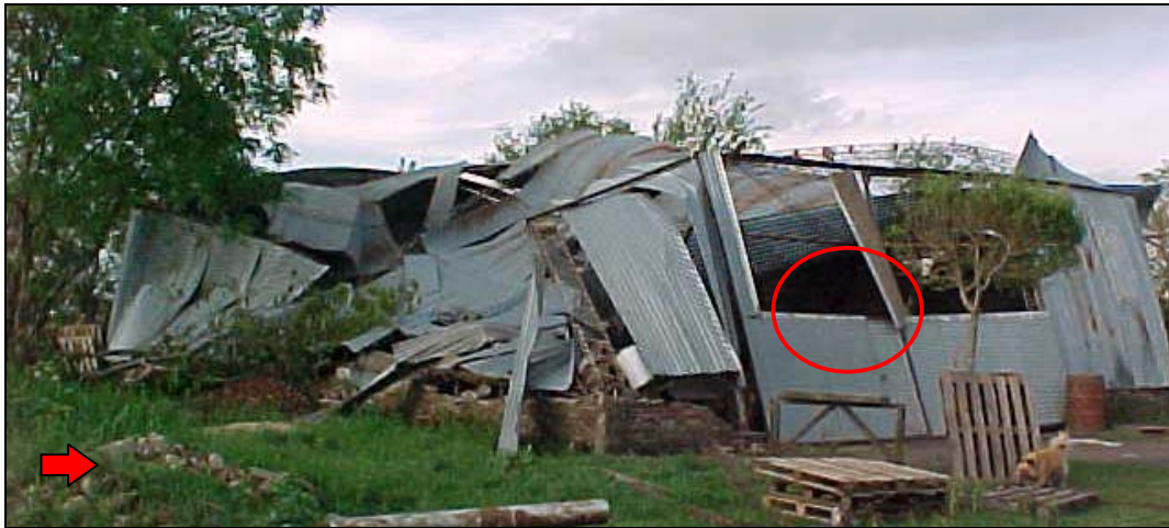
Figura 25: Falla de pórtico por esfuerzo horizontal en su plano. Falta de colaboración entre planos resistentes paralelos (SPRFV). Arrancamiento de chapas en zonas de succión (C&R).
