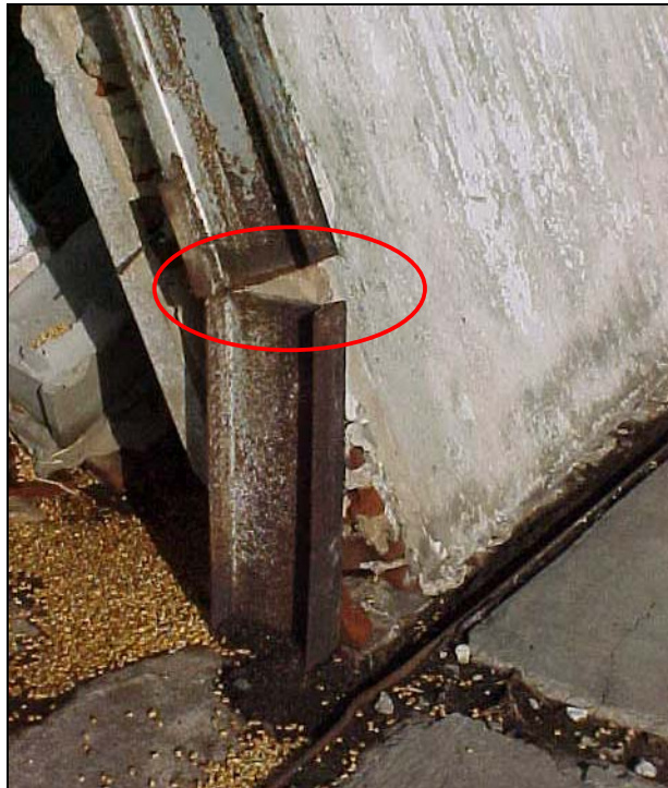
Figura 18: Falla de soldaduras en columna de pórtico, insuficiente penetración y ausencia de soldadura en alas del perfil (SPRFV).
