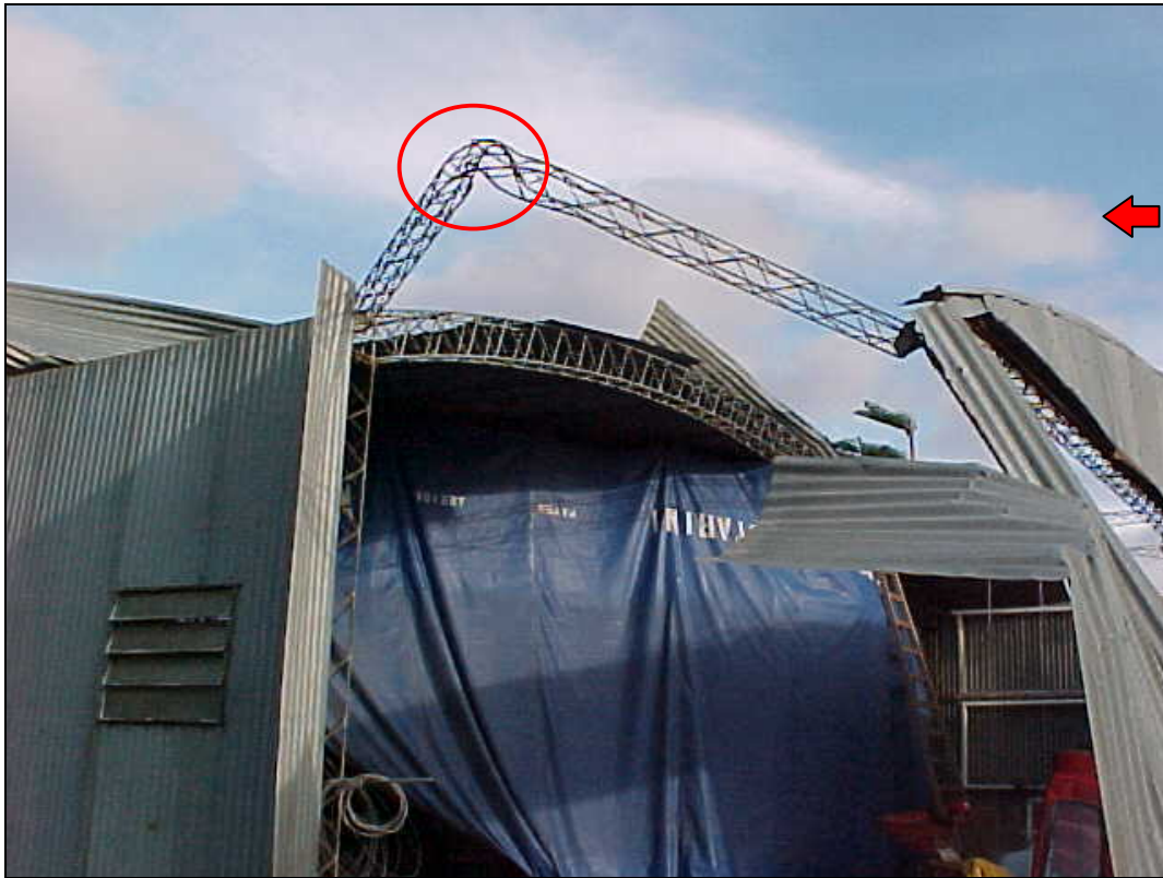
Figura 11: Pandeo general de las correas por empuje en el muro hastial a barlovento (SPRFV).
