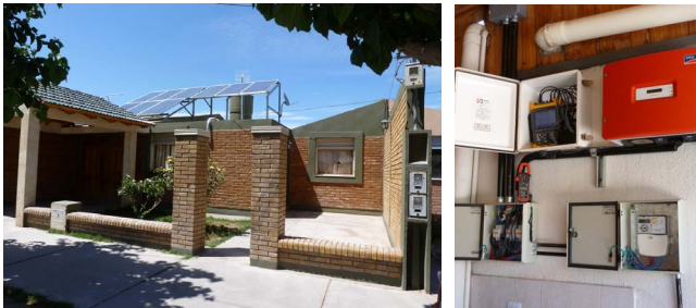
Fig. 4. Foto del proyecto FV en la casa 2: instalaciones externas e internas.
