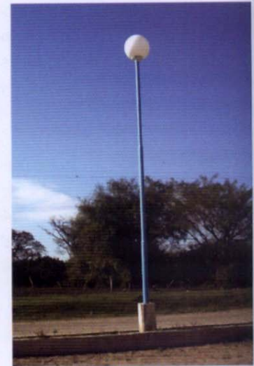
FIGURA 7.- Luminaria tipo globo
