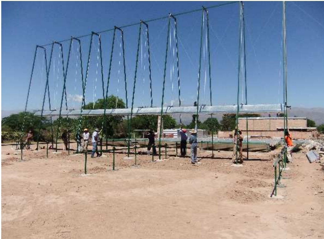
Figura 7: Subida de los absorbedores mediante poleas que los sostienen desde la parte superior de la estructura
