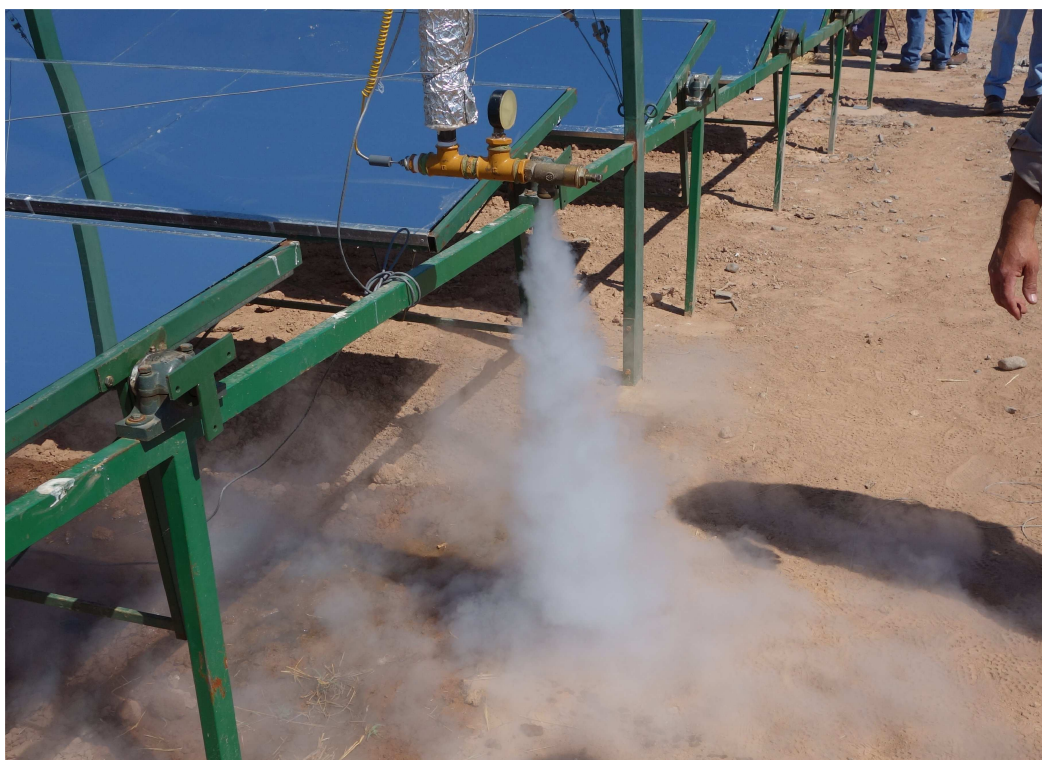
Figura 15.- Expansión del vapor producido en el generador solar térmico con una presión de 30 \text{ Kg/cm}^2 .
