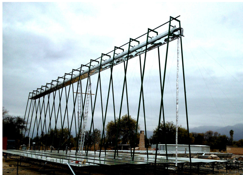
Figura 2.- Vista general del generador mostrando las ocho líneas de espejos de 24 m de largo y el absorbedor de 30 m.
